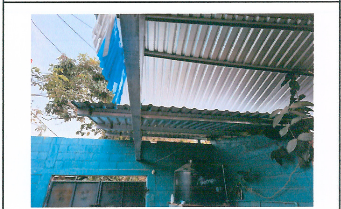
Foto 4: CAIDA DE AGUA FRENTE A LA PILA Y LAVAMANOS
