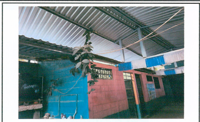
Foto 2: CAIDA DE AGUA EN EL AREA DE BODEGA, BAÑOS Y PILA
