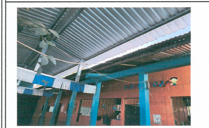
Foto 3: CAIDA DE AGUA FRENTE A LAS DOS AULAS
