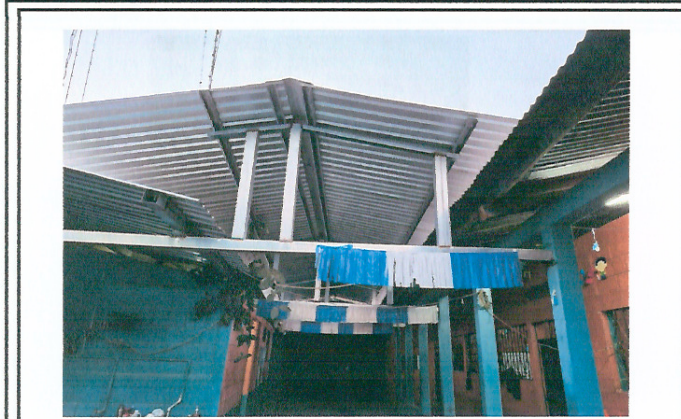
Foto 1: CAIDA DE AGUA EN GENERAL
